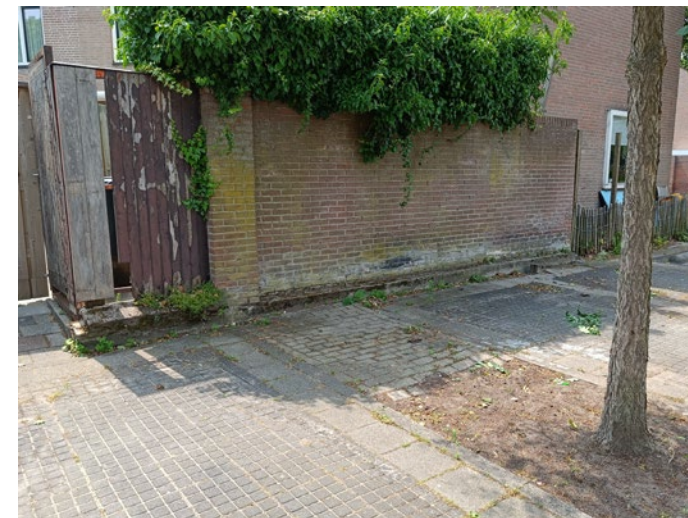
Knelpunt: verzakt maaiveld t.o.v. fundering woningen
